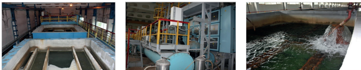
Рис. 2. Сооружения глубокой очистки природной воды
