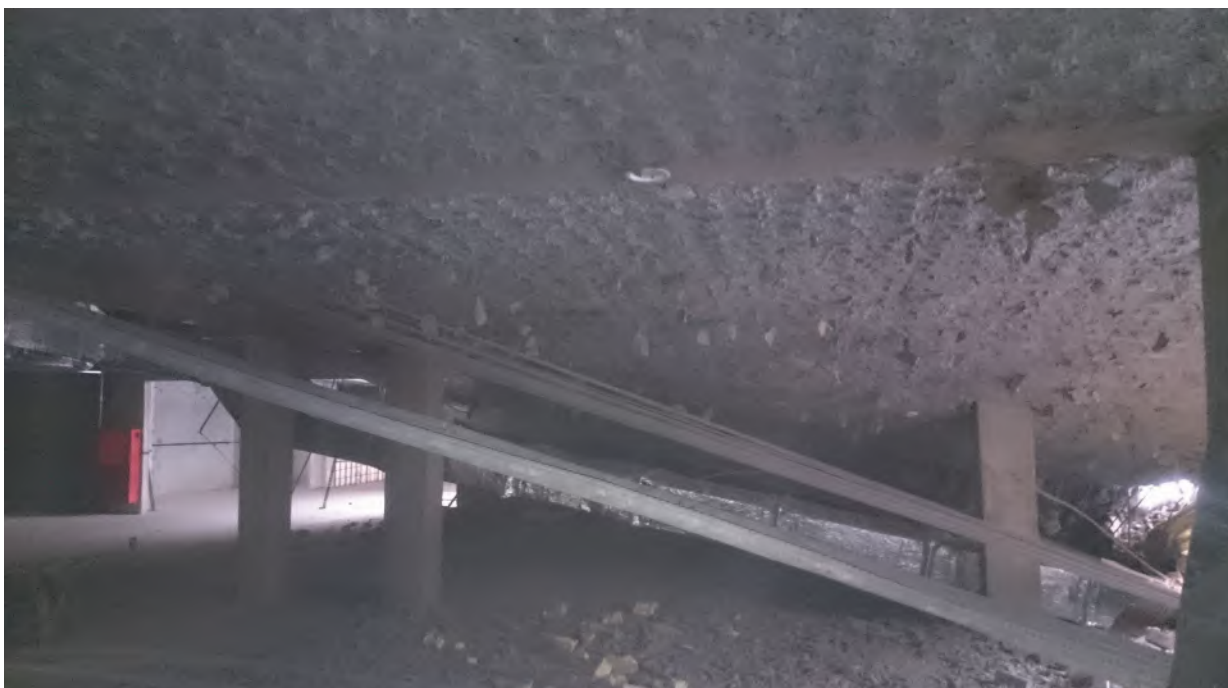
Рис. 5. Обрушение покрытия подземной парковки в г. Сергиев Посад, ул. Фестивальная. Колонны проткнули монолитное железобетонное покрытие в опорных зонах. Отрыв части нижней рабочей продольной арматуры плиты покрытия
