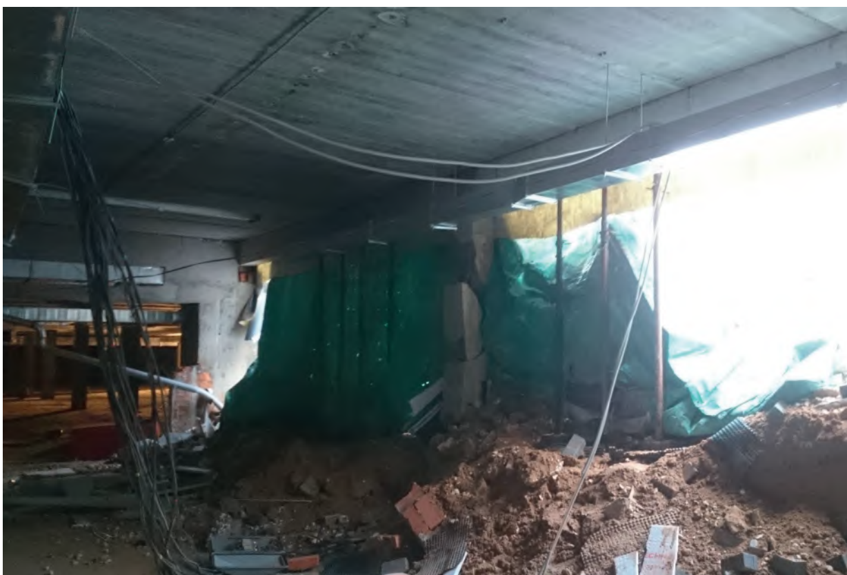
Рис. 4. Обрушение покрытия подземной парковки в г. Сергиев Посад, ул. Фестивальная. Повреждение колонны каркаса жилого дома
