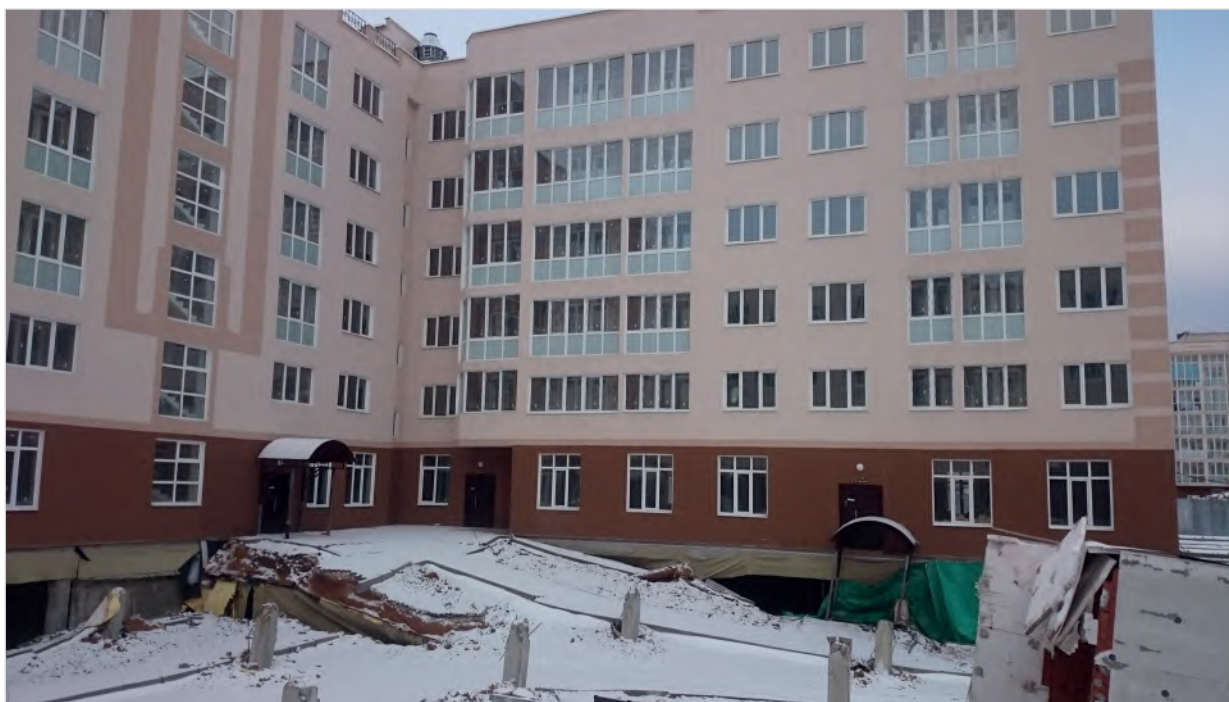
Рис. 1. Обрушение покрытия подземной парковки в г. Сергиев Посад, ул. Фестивальная
