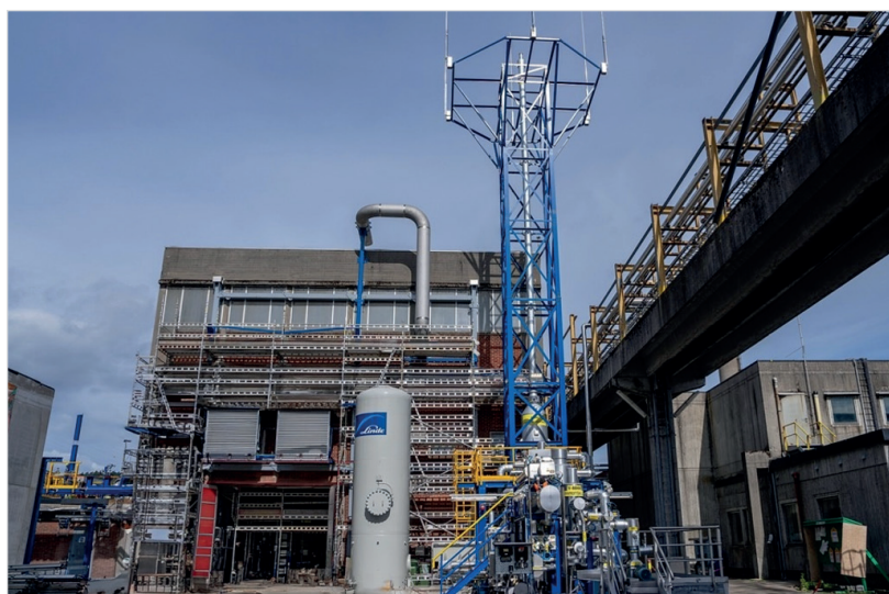
Рис. 3. Водородный завод в Норрчёпинге
